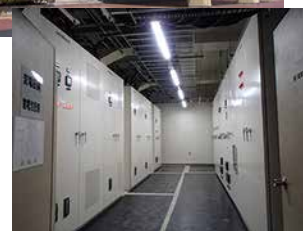
公会堂 主電源室
